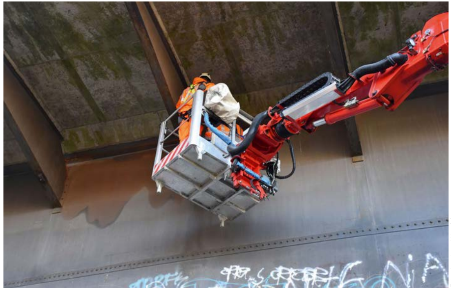
Bild 2 Vor über zehn Jahren war die Brücke bei einer Routineprüfung schon durchgefallen. Ersatz gibt es bis heute keinen.
