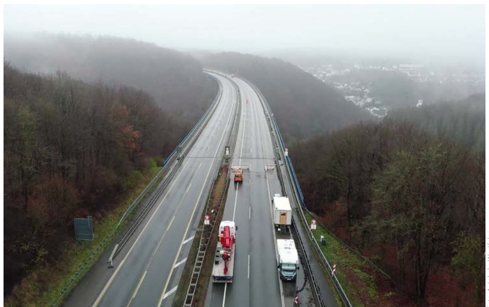
Bild 1 Abbruchreif ist die Rahmede-Talbrücke auf der Sauerlandlinie. Die Hauptträger haben sich bis zum Dreifachen der zulässigen Werte verformt.
